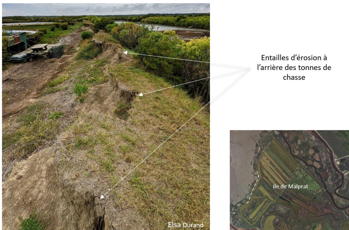
Figure 31 : Entailles d'érosion observées au niveau de la digue à la mer de l'île de Malprat représentée en pointillés sur la vue aérienne à droite (septembre 2021)
