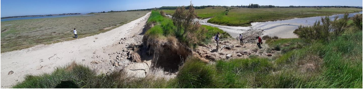
Illustration 15 – Vue de la brèche depuis la digue côté Sud le 04 Juin 2020 (Conservatoire du littoral).
