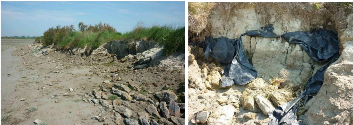
Illustration 12 – Aperçu des dommages sur la face externe de la digue après l'hiver 2009-2010 (Conservatoire du littoral, 2011).
