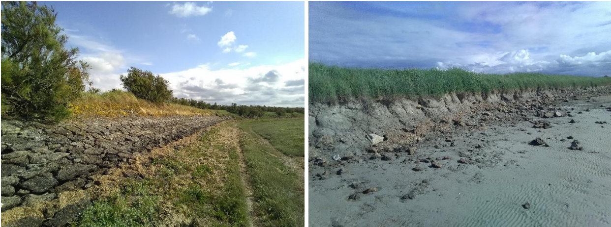
Illustration 21 – Aperçu de la partie encore empierrée (à gauche) et de la partie érodée (à droite) de la digue des Marais-Neufs le 07 Juin 2020 (BRGM).
