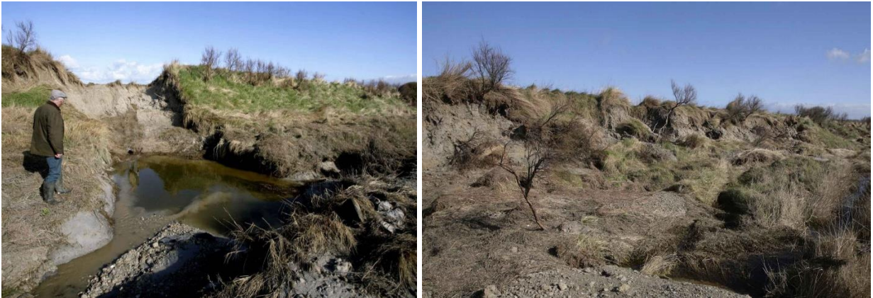
Illustration 11 - Aperçu des dommages au polder de Ploubalay le 10 Mars 2008 : Vue de la principale brèche (à gauche) et de l'état intérieur de la digue (à droite) (Conservatoire du littoral, 2008).
