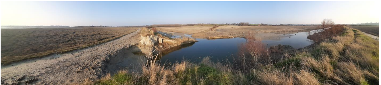
Illustration 17 - Vue de la brèche depuis la digue côté Sud le 08 Mars 2021, avec la végétation du polder brulée par l'eau de mer (Conservatoire du littoral).
