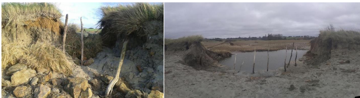
Illustration 14 – Vue de la brèche actuelle depuis l'estran à son apparition le 12 Mars 2020 (à gauche, Conservatoire du littoral) et durant son agrandissement le 12 Janvier 2021 (à droite, BRGM).
