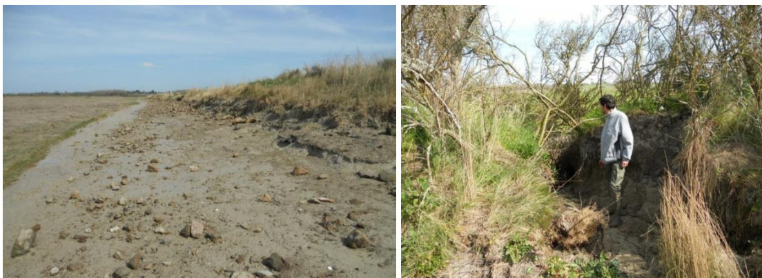
Illustration 13 - Aperçu des dommages sur la digue après l'hiver 2013-2014 : Face externe rongée par la mer (à gauche) et apparition d'une petite brèche (à droite) (Conservatoire du littoral, 2014).
