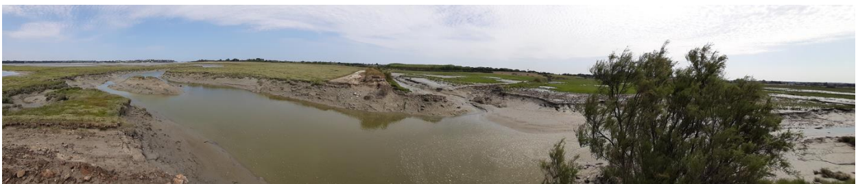
Illustration 18 – Vue de la brèche depuis la digue côté Sud le 30 Août 2022 avec le chenal qui s'est creusé en une marée en avril 2021 (Conservatoire du littoral).
