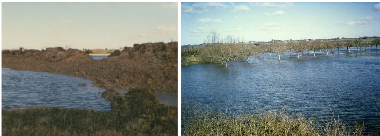
Illustration 9 – Aperçu des dommages au polder de Ploubalay en Février 1990 : Vue d'une brèche (à gauche, d'après Acquaviva et al., 2016) et de la submersion occasionnée (à droite) (d'après Bonnot-Courtois et al., 2008).
