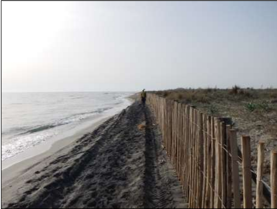
Illustration 37 - Système de ganivelles en pied de dune sur le littoral de la Marana (secteur n°2 au nord du lotissement de la Marana ; vue vers le sud ; crédit photo : ROL/BRGM, 07/04/2016).
